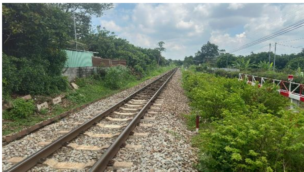
Hình 19: Hiện trạng đường sắt Bắc Nam qua xã Bà Trâm
